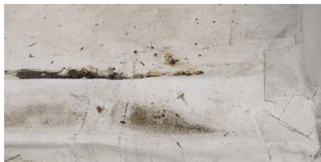
Падение непогашенных окурков сигарет на кровлю. Особенно это касается кровель, расположенных под окнами гостиниц.
